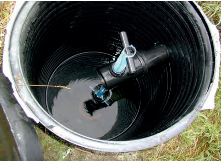
Kuva 4.4. Padottava salaojakaivo, eli säätökaivo. Kuva: Rainer Rosendahl
